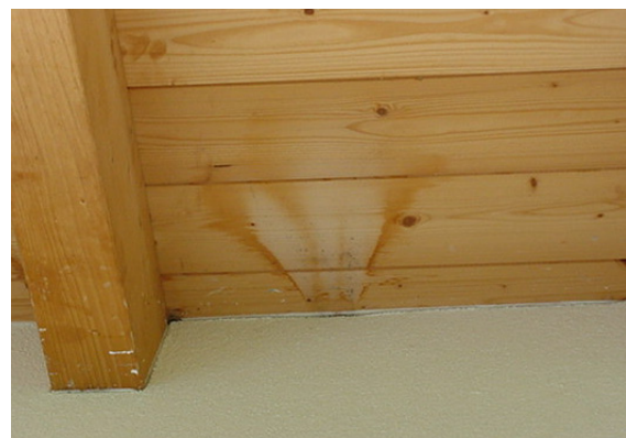
Figure 16: L'air chaud et humide s'exfiltrant de la pièce se condense sur les panneaux de toiture et décolore clairement le bois.
