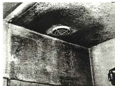
Fig. 1 Schimmels in een badkamer in een nieuwbouwwoning. Het aangetaste oppervlak bestaat hier uit een spuitpleister op een geïsoleerde buitenwand, binnenwand en plafond onder een verwarmde zolderruimte. De badkamer is voorzien van een permanente basisventilatie (foto IBBC-TNO)
