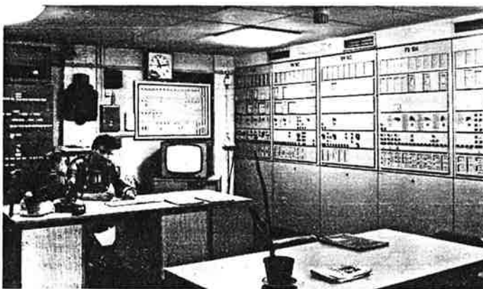
6 Zentrale Schaltwarte im Funktionsgebäude
