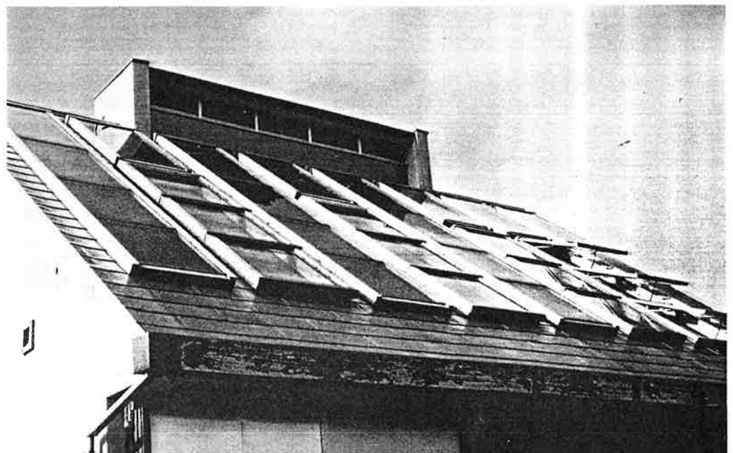
Capteurs solaires « collés » en toiture (contact étanche)
