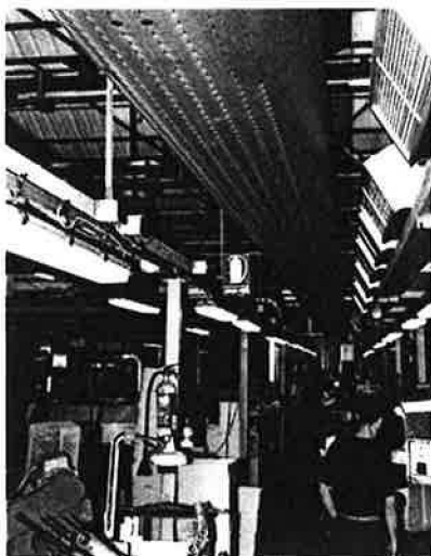
Figura 5 - Canale dalla foratura particolare installato sull'asse del corridoio
