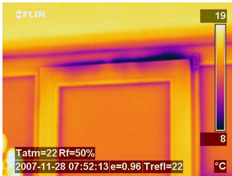
Abb. 4: Thermogramm Leckortung bei Unterdruck (ca. 50 Pa)
