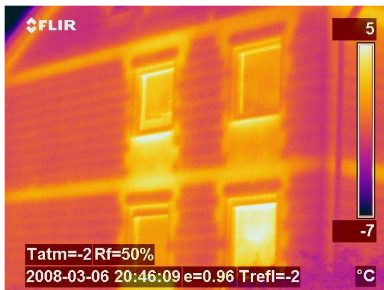
Abb. 3: Thermografieaufnahme verputztes Mauerwerk mit Wärmebrücken im Bereich der Zwischendecken bzw. rund um die Fenster (Stürze, Rollladenkästen, Heizkörper)
