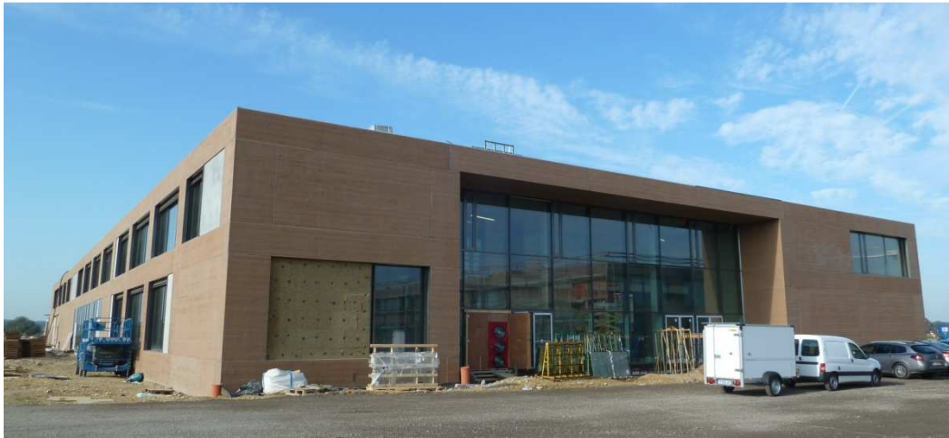
Abb. 8: Schulneubau in Luxemburg, Mensagebäude Public, mit eingebautem MessSystem BlowerDoor MultipleFan
