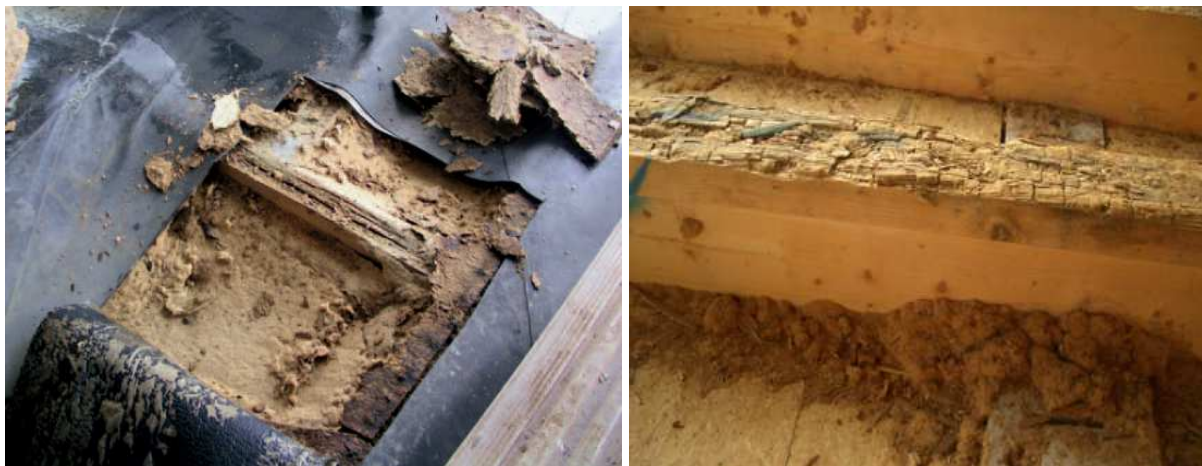
Bild 3: Kapitaler Bauschaden infolge falsch eingestellter Lüftungsanlage [2]
