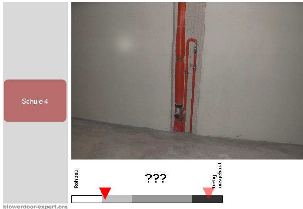
Bild 9: Beispielhafte großflächige Leckage (luftführendes Mauerwerk entlang entlang eines breiten Schlitzes über mehrere Etagen)
