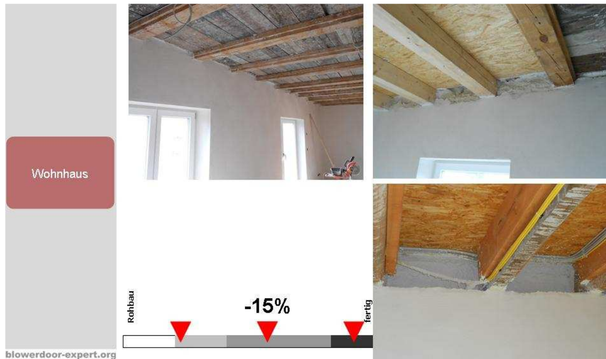
Bild 10: nachträglich verspachtelte oder mit Putzmörtel beworfene Wandpartien zwischen Deckenbalken; darüber verbleibt immer noch ein unverputzter Streifen, der nur zugänglich wird, wenn man die tragenden Platten zurückschneidet
