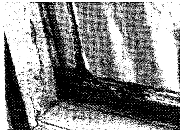
Figur 36 Betydelig råte, kitt og glass løst og slark i rammen. Bør skiftes ut
