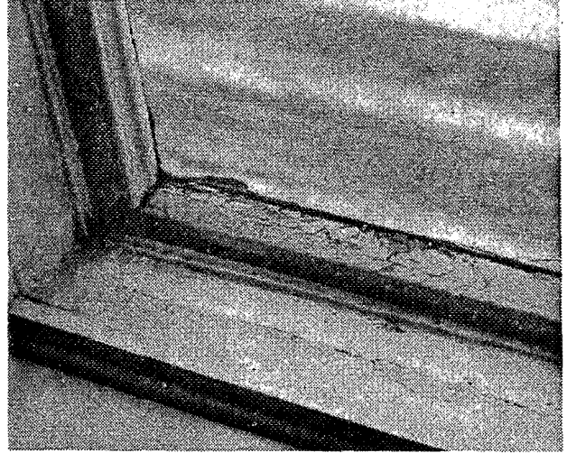
Figur 34 Fuktskader i kittfals og hjørner, sparkel i bunnkarm oppsprukket og beslag løst. Ramme bør skiftes ut.
